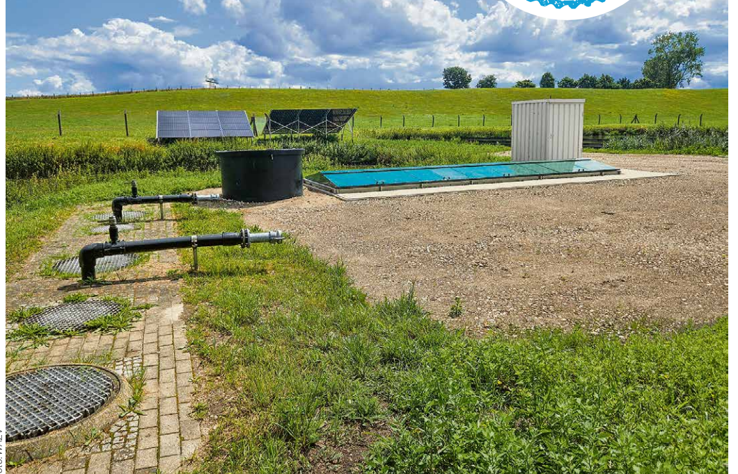
Die Technik der Kläranlage Stralendorf wird überwiegend mit Solarstrom betrieben – so sinken die Betriebskosten. Auf dem Bild sieht man die Scheibenrotationsanlage mit Solarpanelen und Speicherraum.
