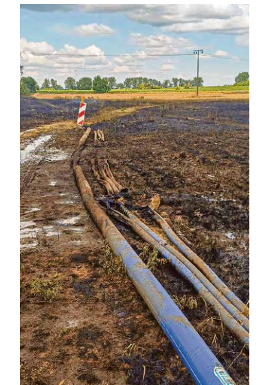
Bei einem Flurbrand wurden gut 600 Meter vorverschweißte Trinkwasserrohre beschädigt.
